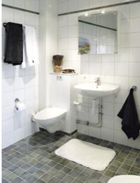
Schakt (V3016) och WC-modul med sidoanslutet tvättställ
