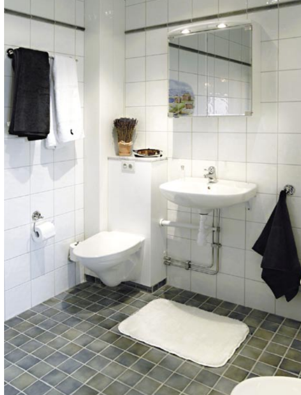
Sjakt (V3016) och WC-modul med sidetilkoblet servant
